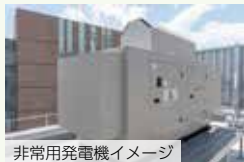
非常用発電機イメージ
