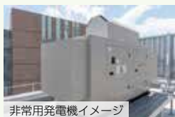
非常用発電機イメージ
