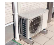
エアコン室外機
