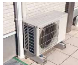
エアコン室外機
