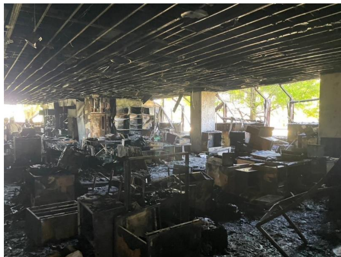
出火箇所(左側奥)
