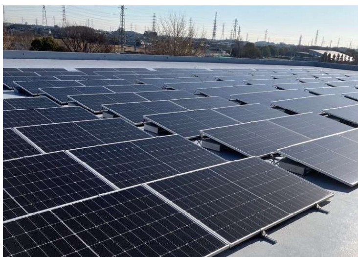
白岡市生涯学習センター〔こもれびの森〕の屋上に設置されているソーラーパネル
