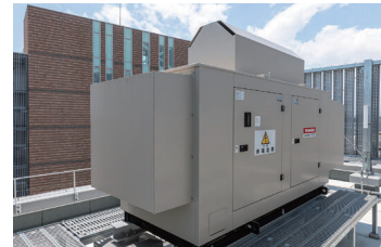
非常用発電機イメージ
