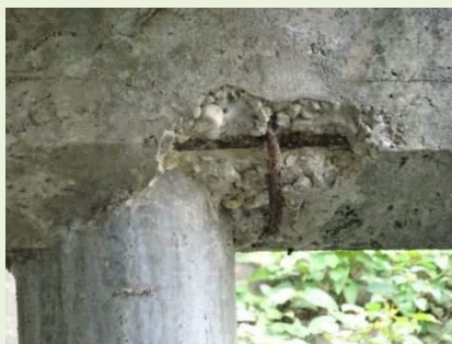
鉄筋露出状況
