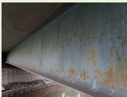
塗装の劣化状況
