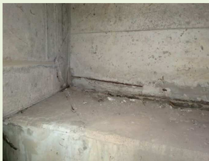
鉄筋露出状況
