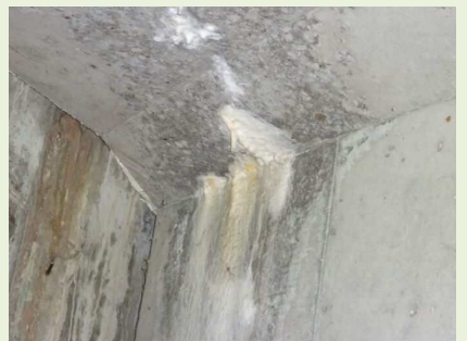
遊離石灰発生状況
