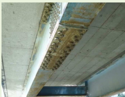
塗装の劣化状況
