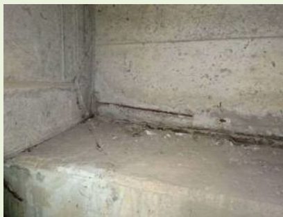
鉄筋露出状況
