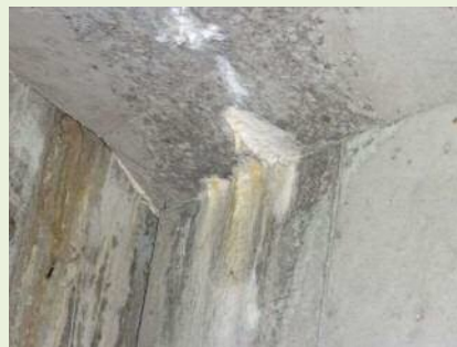
遊離石灰発生状況
