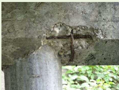
鉄筋露出状況
