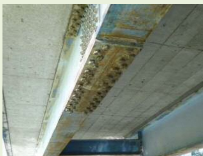
塗装の劣化状況
