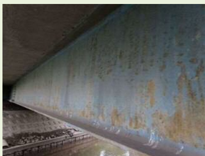
塗装の劣化状況
