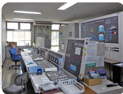
中央監視制御室
