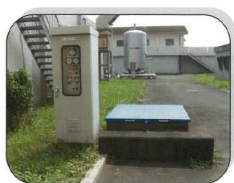
岡泉1号取水井
