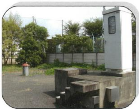
高岩1号取水井
