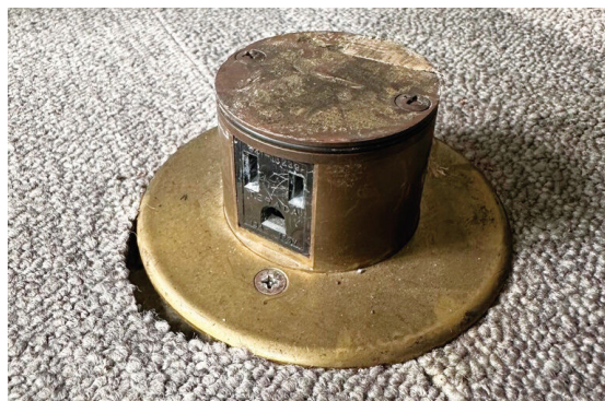
同タイプの床コンセント
