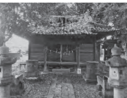
屋根の損傷が著しい 岡泉神社拝殿
