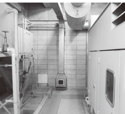
庁舎の非常用電源
