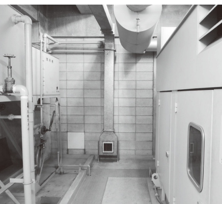
庁舎の非常用電源
