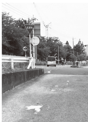
見えにくい路面標示
