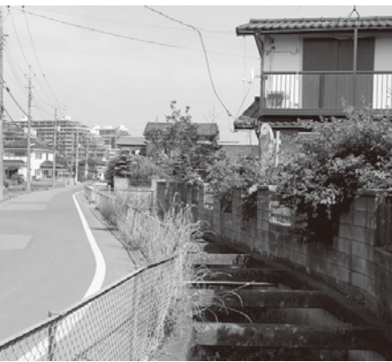
蓋掛けされていない水路
