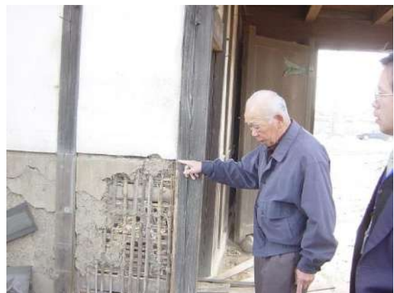
長屋門に残された修復痕
