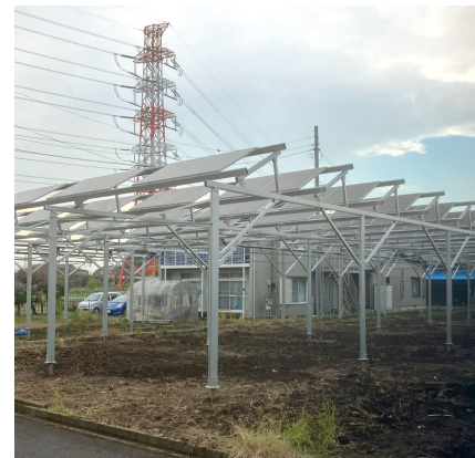
市内初設置のソーラーシェアリング
