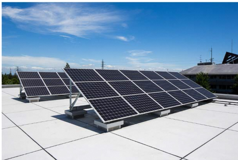
白岡市生涯学習センター「こもれびの森」の屋上に設置されているソーラーパネル
