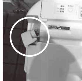
壊された便器
