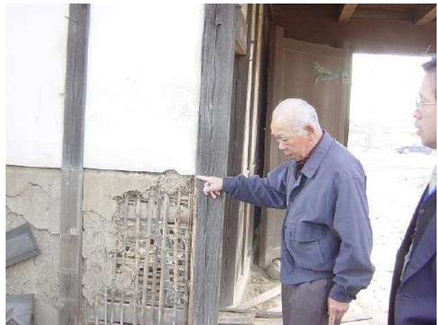
長屋門に残された修復痕
