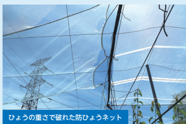
ひょうの重さで破れた防ひょうネット
