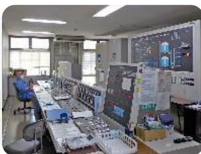
中央監視制御室
