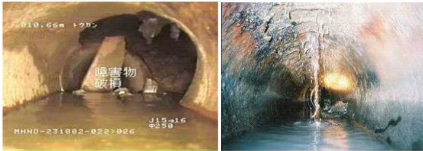
破損した管路
