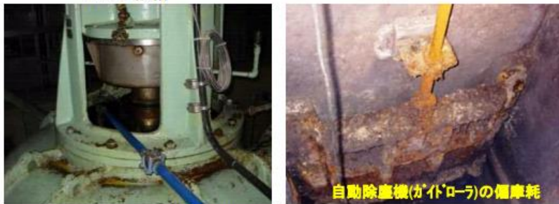
ポンプ本体(内部軸受)の劣化
