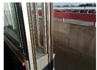
新幹線高架に面した二重サッシ（西小）
