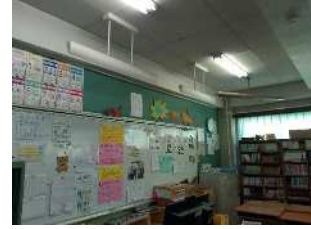
大半の学校で黒板灯が吊り型照明となっており未対応（篠津小）
