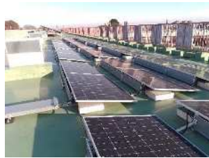
屋上一面に太陽光発電（西小）
