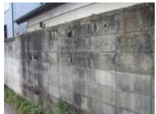
老朽化したブロック塀
