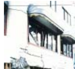
窓ガラスの破損
